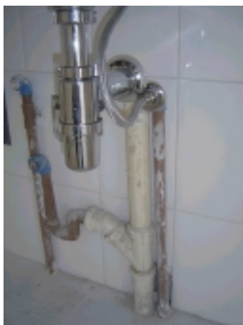
detalhe das tubulações aparente da pia da cozinha
