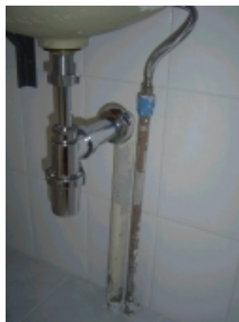
detalhe das tubulações aparente da pia do banheiro
